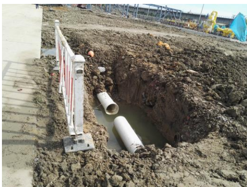
厂区雨水管道
